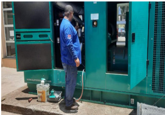
5- PREVENTIVA DE GERADOR V.CRISTINA
