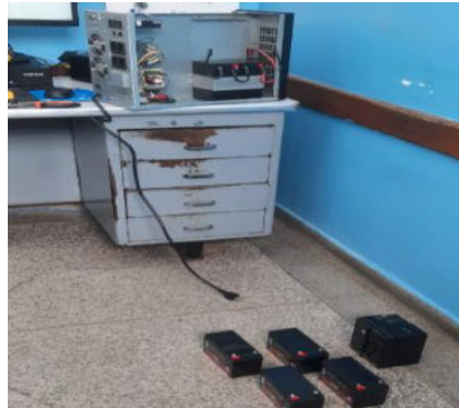
11-TROCA DE BATERIAS NOBREAKS
