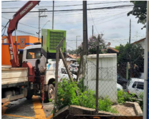
2 -INSTALAÇÃO GERADOR ALUGADO
